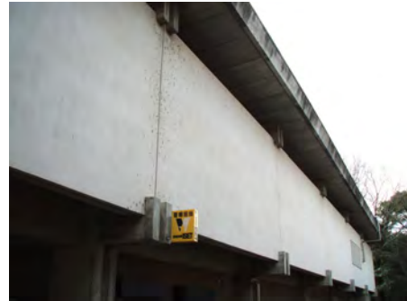
壁面老朽化状況
