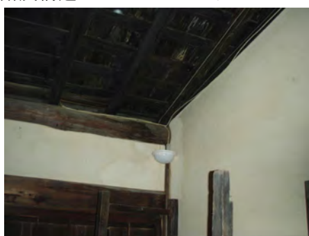
雨漏確認状況
