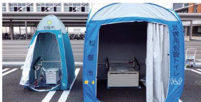
マンホールトイレ
