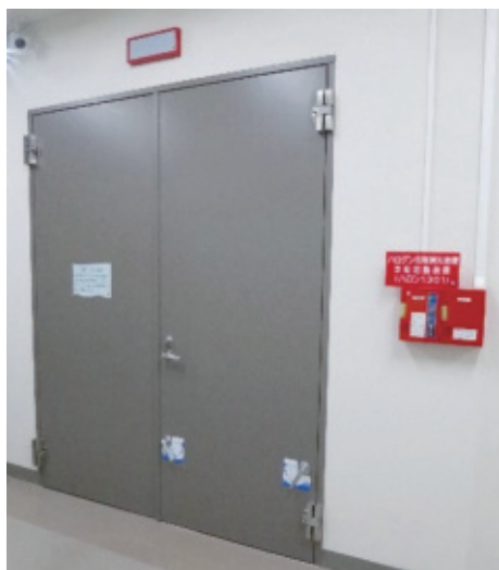
収蔵庫に設置した止水扉
