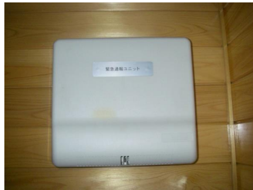
⑩緊急通報装置
