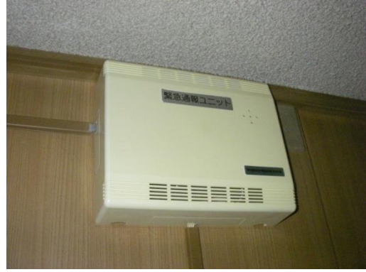
⑩緊急通報装置
