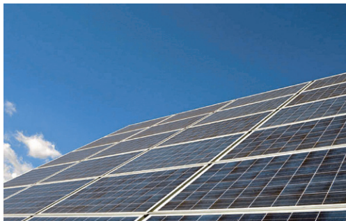
▲太陽光発電設備
