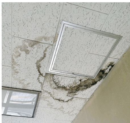
▲雨漏りした天井の染み
