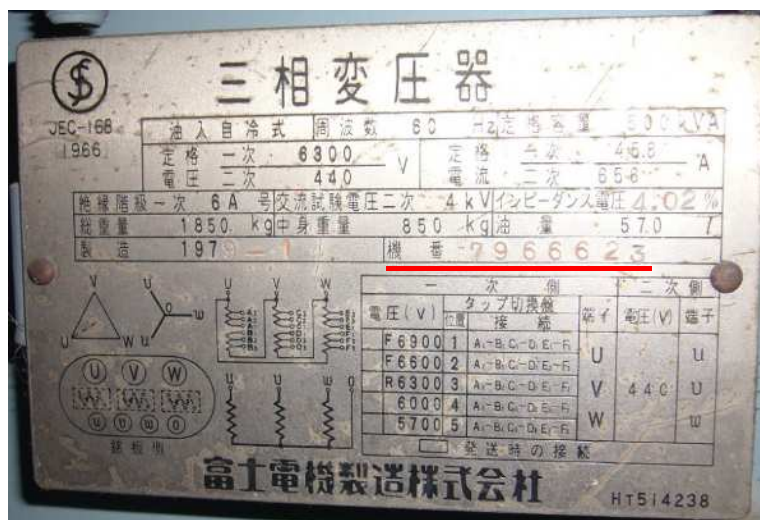
写真8. 変圧器「4」銘板 (機番：7966623)
