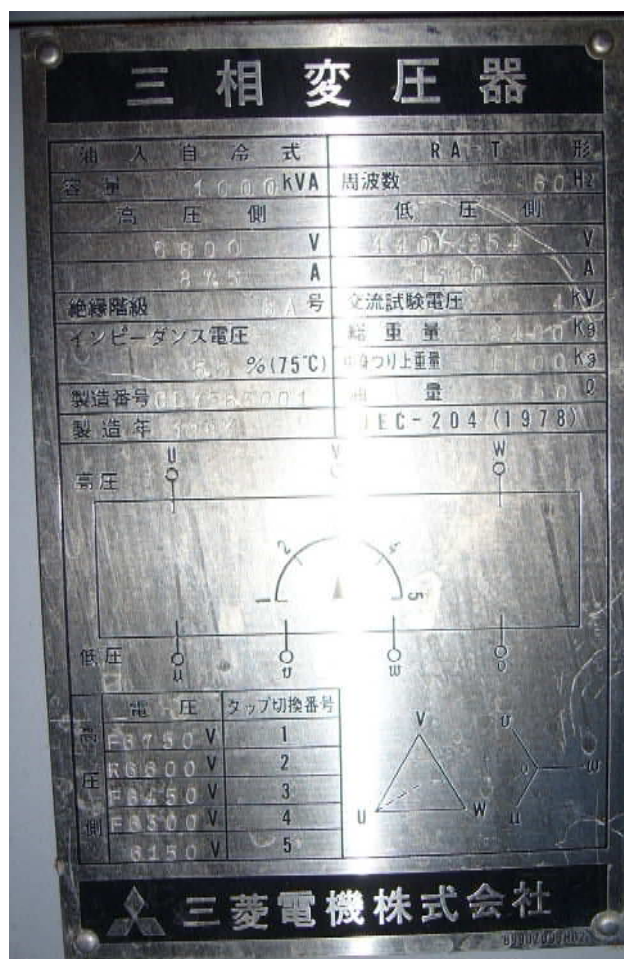
写真2. 変圧器「28-001」銘板 (機番：記載なし)
