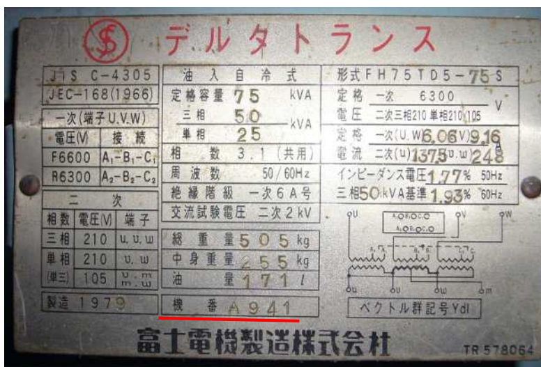
写真6. 変圧器「3」銘板 (機番：A941)
