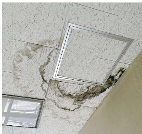
▲雨漏りした天井の染み
