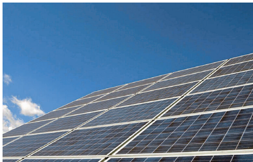
▲太陽光発電設備
