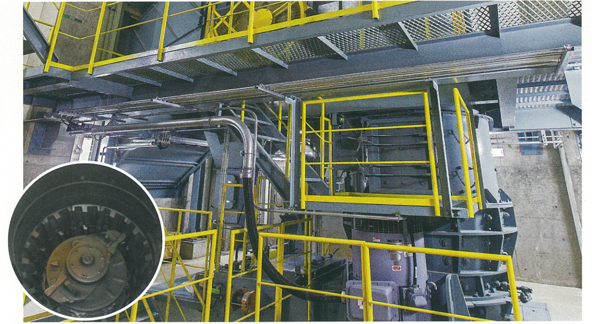
■高速回転式破碎機 高速回転するブレーカでごみを砕き、グラインダーですりつぶして、燃えないごみを細かくします。
