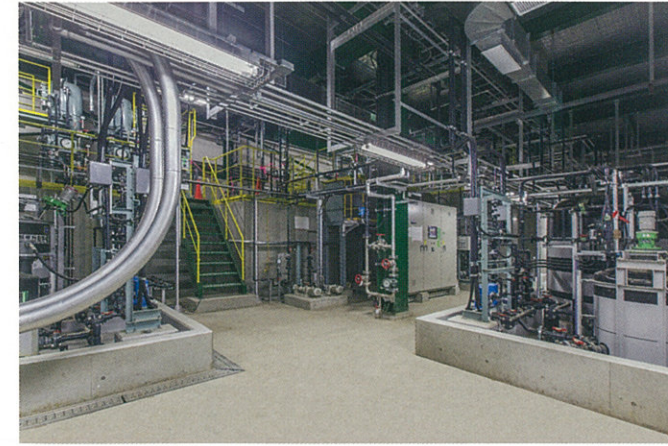
■排水処理室 施設内での排水を生物処理、凝集沈殿、砂ろ過処理などを行ってきれいな状態にします。処理後の水は施設内で再利用します。
