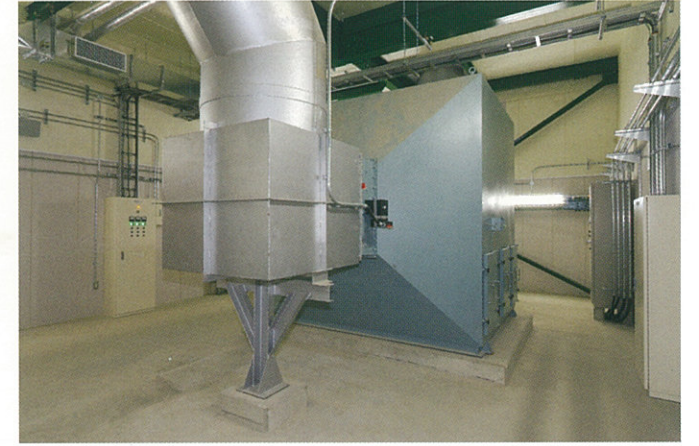
■脱臭装置 焼却炉停止時にも臭気を外部に漏らさないための装置です。
