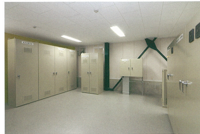
■電気設備(破碎選別施設) 破碎選別施設の各所へ電気を送る設備です。
