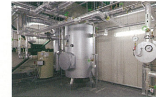
余熱利用設備
