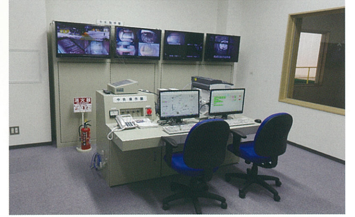
■中央制御室 施設全体の処理ラインを管理します。機器の状態や処理の状況をモニタなどで監視し、安全で効率の良い運転を行います。
