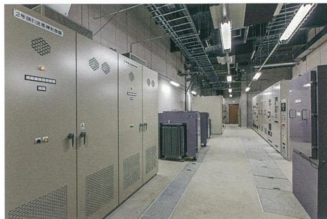
■電気設備(焼却施設) 焼却施設の各所へ電気を送る設備です。
