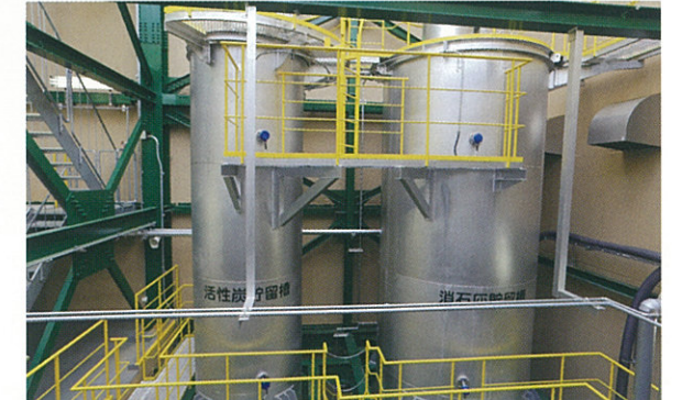
■有害ガス除去装置
