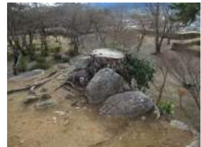
樹根が石垣(No. 013)の天端石を起こしている
