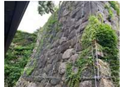
間詰め石を詰めてから落石防止ネットを設置した石垣(No. 227)
