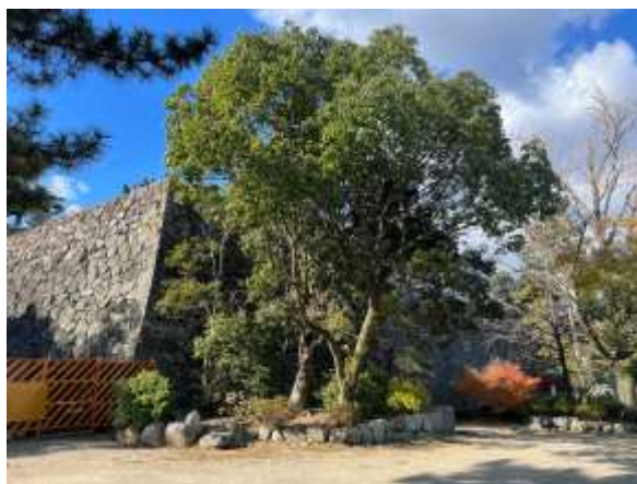
石垣(No. 108)の前面に繁茂する樹木
