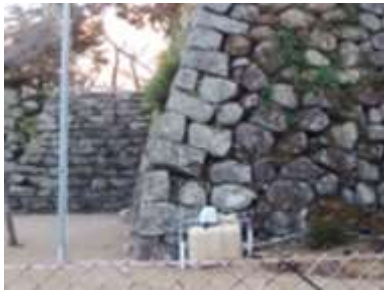
隅角部が座屈している(No. 020)
