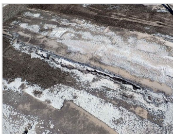
屋上防水シートの損傷
