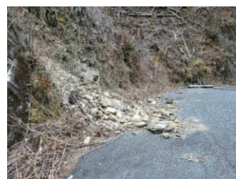
▲栗野田引旧国道線の崩れの様子
