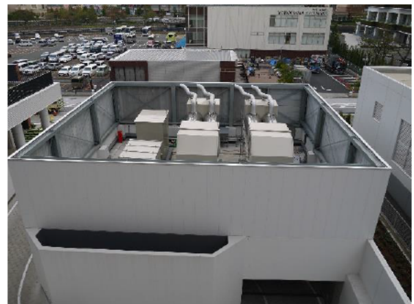
■ 電気設備の見下ろし
