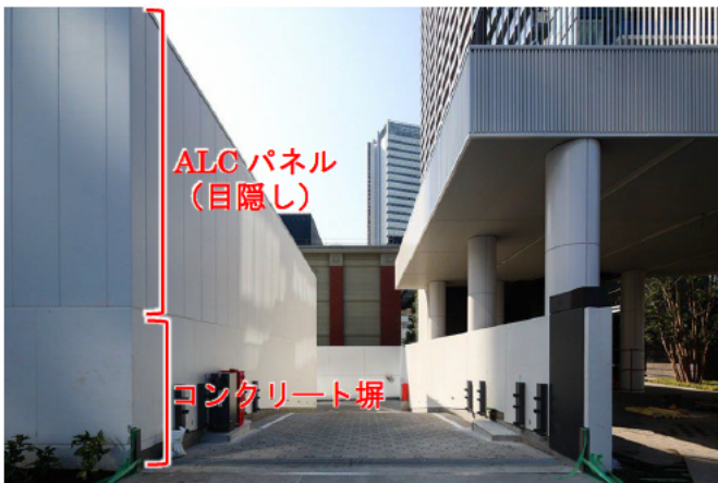
■ 電気設備周囲の塀
