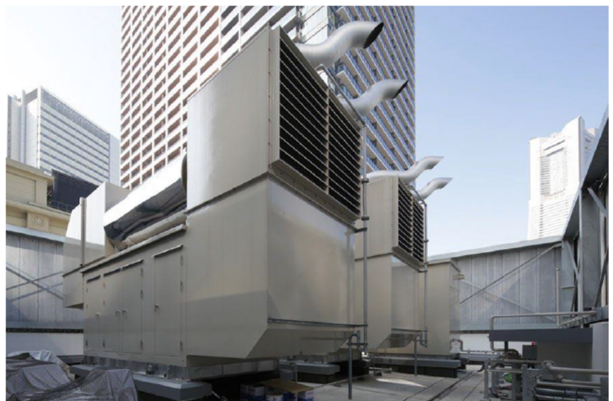
■ 塀の内側に設置された非常用発電設備
