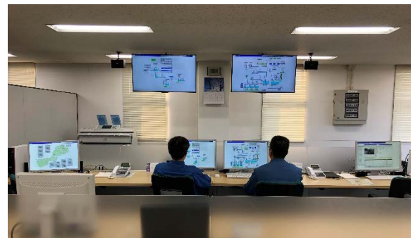
図 3-3 遠方監視システム(中央監視室)
