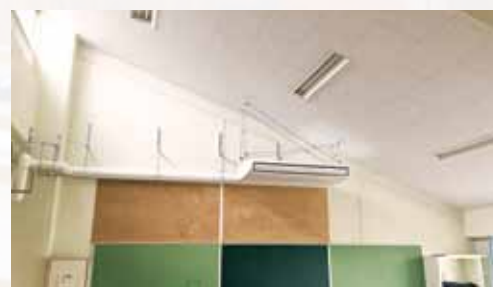
▲小中学校空調設備
