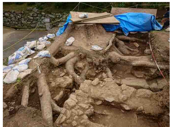
石垣変形の主要原因となったクロマツの根
