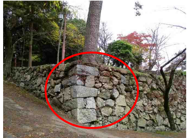
石垣修理前（大きく変形した部分）
