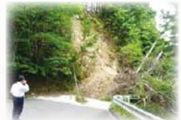
▲放置状態の土砂崩れ
