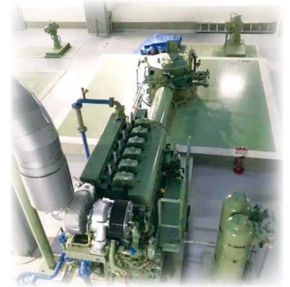
▲増設される大口ポンプ場
