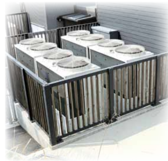
▲ガスエアコン室外機
