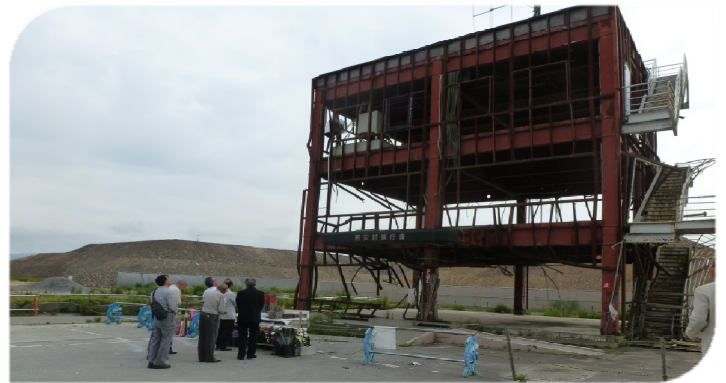
【 南三陸町防災対策庁舎 】
