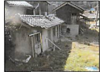
老朽化した廃屋
