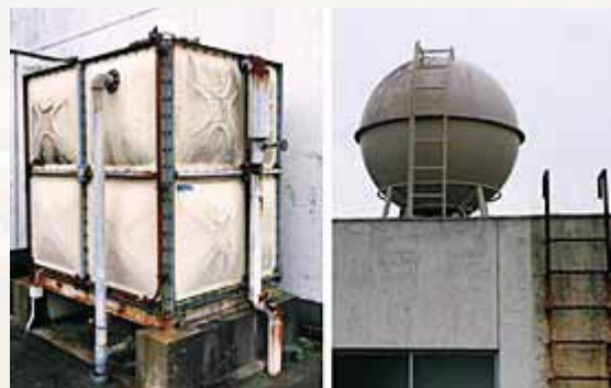
避難所の高架水槽・受水槽
