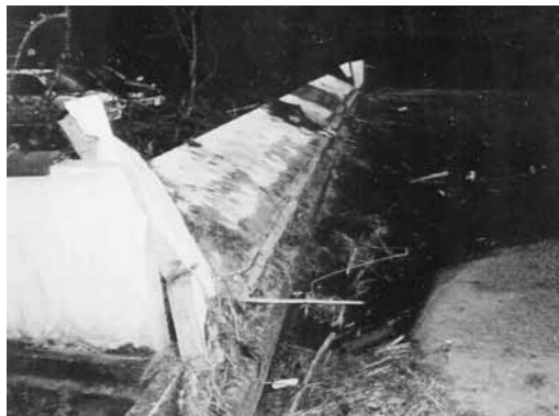
水害により幅の広いブロック塀が倒れている (嬉野小原地区)
