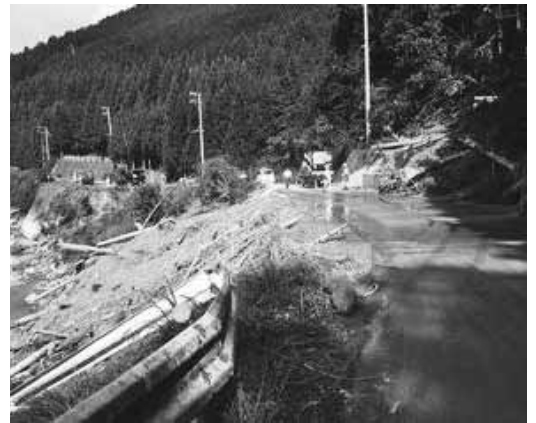
緊急対応で土砂の除去が行われた道路（飯高管内）
