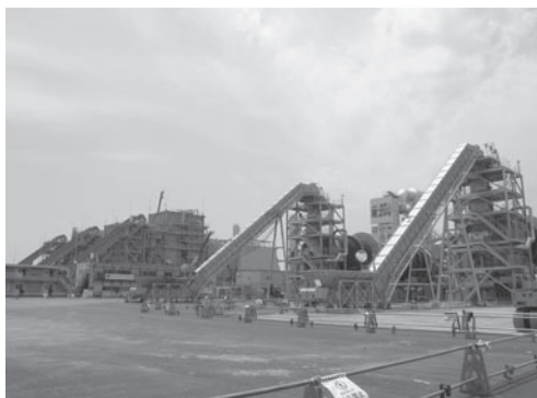
石巻市に宮城県が設置した5基の仮設焼却炉 5基で1日1500トンの処理が可能
