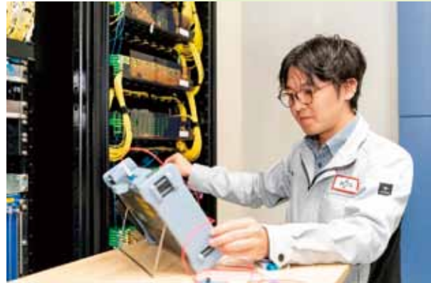
機械室（ヘッドエンド室）でメンテナンスを行う技術部社員
