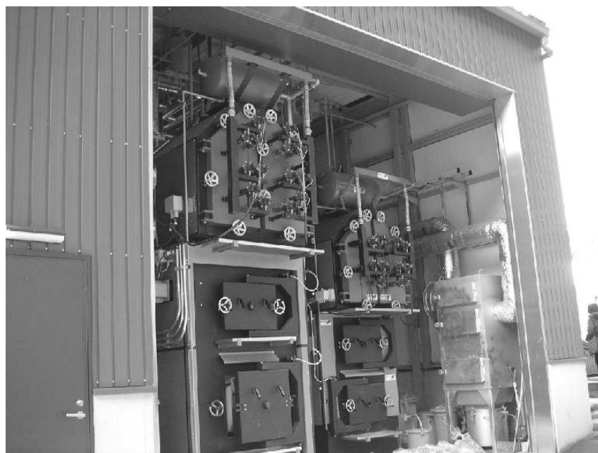
導入例：徳島県勝浦郡上勝町 森林資源バイオマス施設
