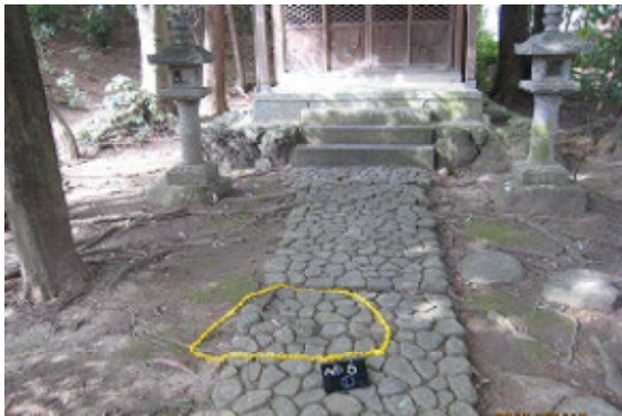
石組 敷石の不陸
