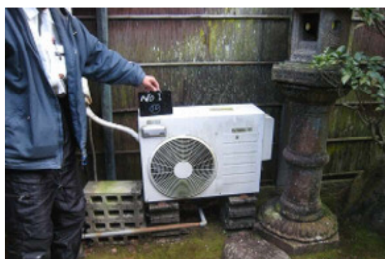
その他 空調室外機
