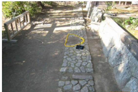
石組 敷石の沈下
