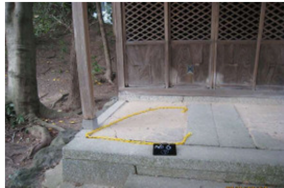
建造物 稲荷社の土間三和土の劣化・風化
