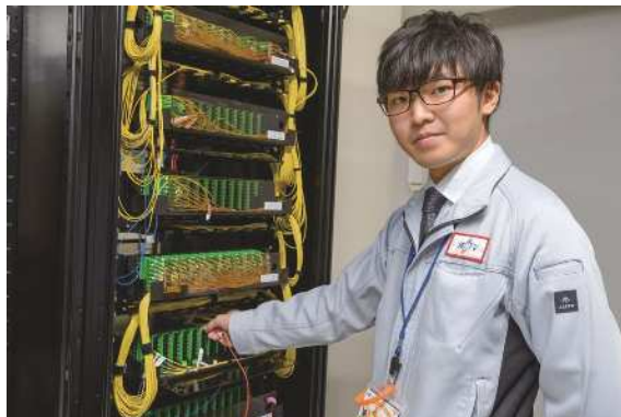
機器を管理するヘッドエンド室
