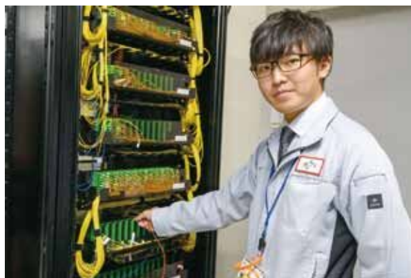
機器を管理するヘッドエンド室
