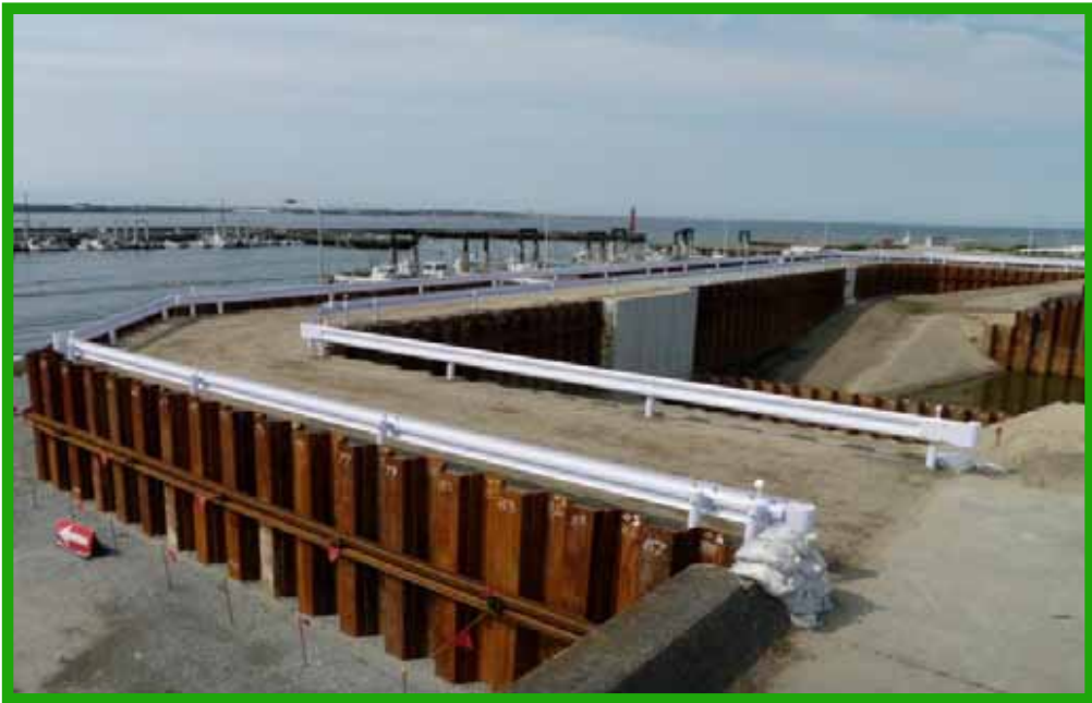
平成21年度獺師漁港海岸保全施設整備事業工事 (株田村組)
