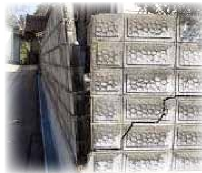
▲危険ブロック塀
