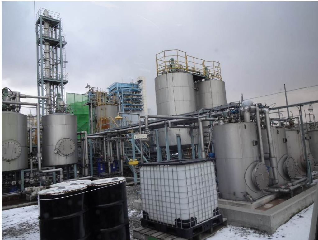
JA全農 バイオエタノールプラント
