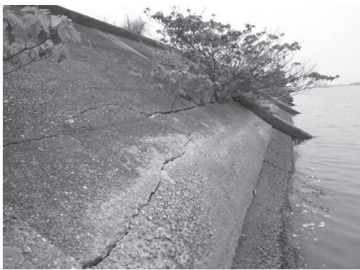
堤防の裂け目から木が！
