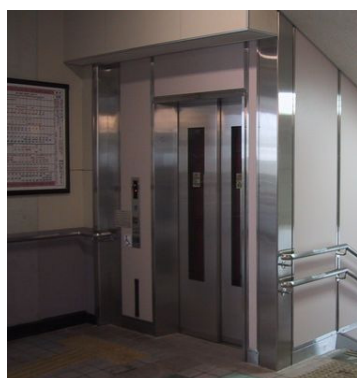
■ 松阪駅に設置されたエレベーター
