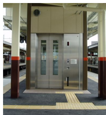
■ 近鉄伊勢中川駅に設置されたエレベーター
